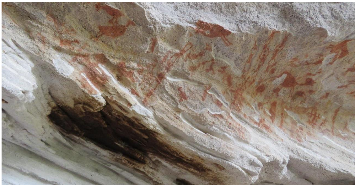
Figura 13: Mancha de fungos dentro do abrigo, abaixo das pinturas rupestres. Fonte: Arquivo imagético da Fumdam, ano 2019.
